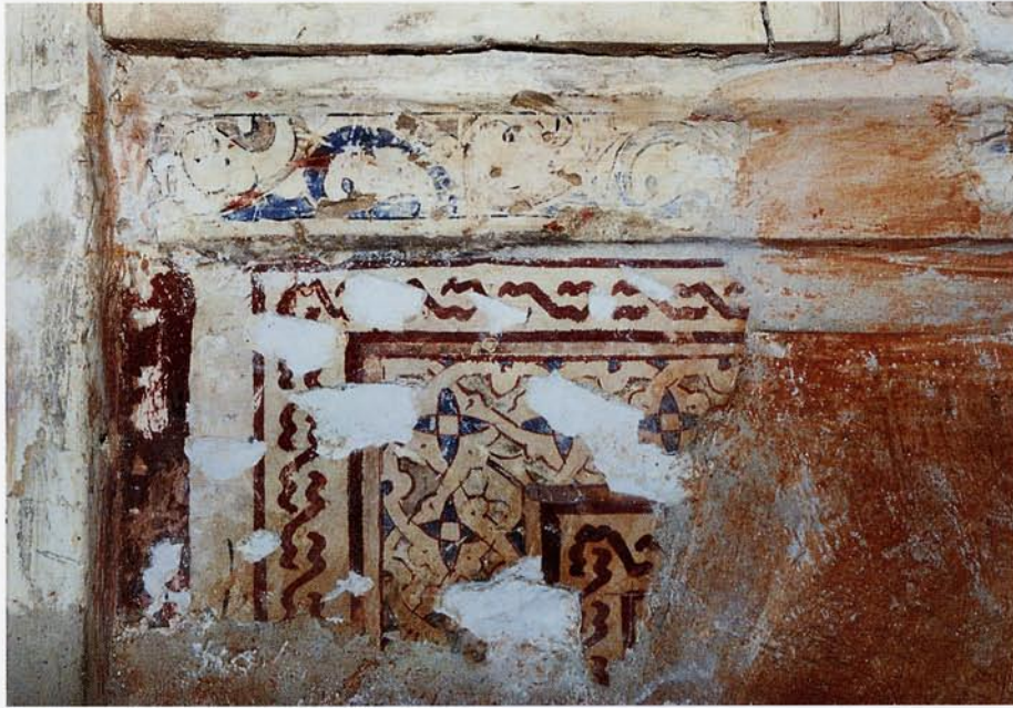
Lám. 33. Patio del Harén. Paramento A 2. Las superficies después de realizar los repintes aparecen con la composición cercenada y difíciles de percibir.
