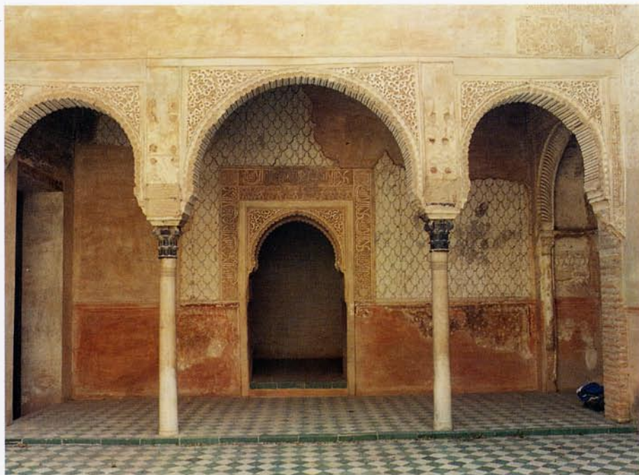
Lám. 25. Patio del Harén. Vista general del paramento A antes del tratamiento de conservación.
